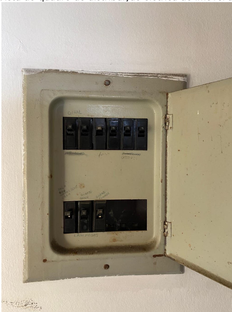
FOTO 6: Vista do quadro de distribuição elétrica do imóvel avaliando.
