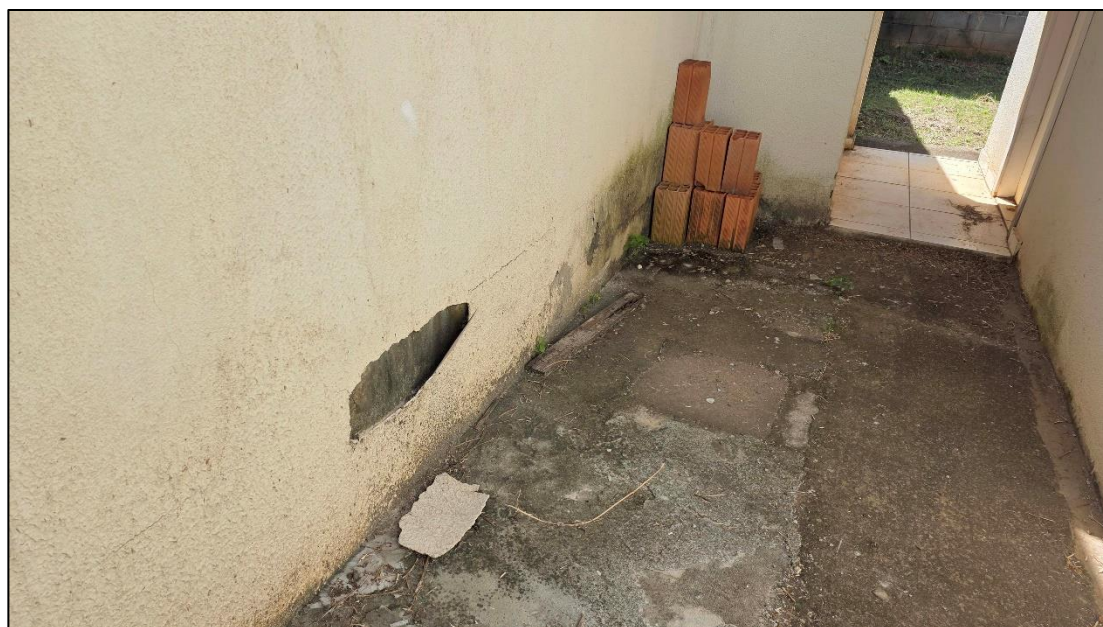
Imagem 26: Destaque para o estado de conservação do imóvel e algumas patologias como necessidade de troca de batentes e portas, pontos de umidade e fissuras.
