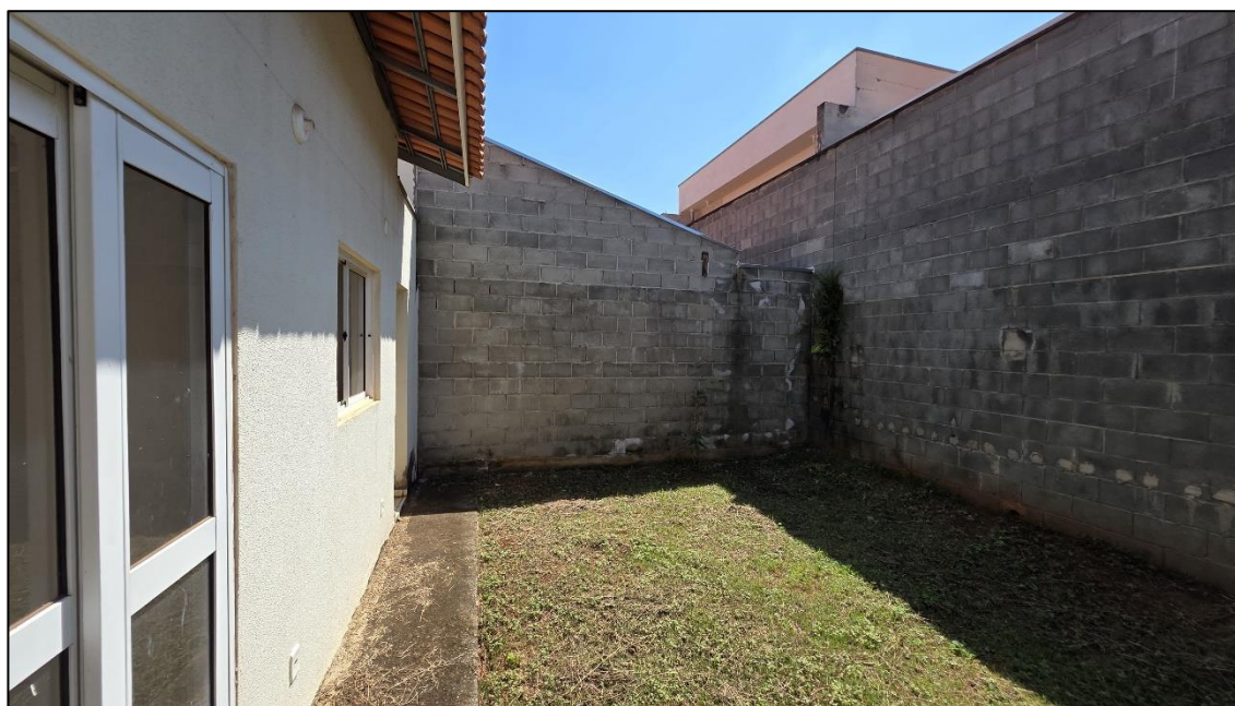
Imagem 23: Fundos da unidade dispendo de quintal/gramado. Muros sem reboco com tijolos aparentes.
