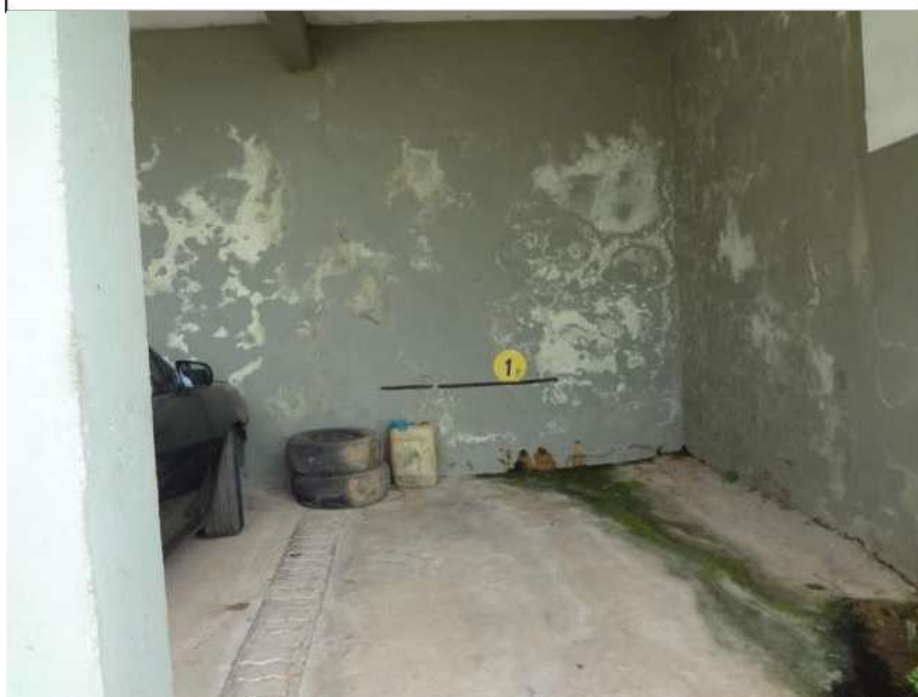
FOTO 41: Água mau cheirosa que escorre por dentro da garagem através do muro que confronta com a fossa.
