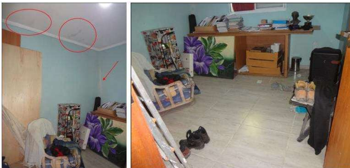
FOTO 51: Presença de infiltração em um dos Quartos. Segundo Quarto, não vistoriado.
