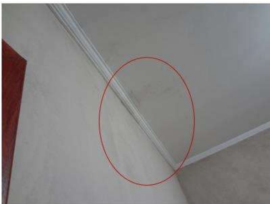
FOTO 61: Presença de infiltração nos quartos.
