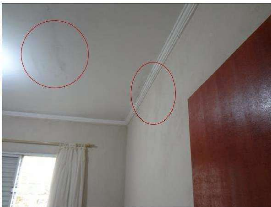
FOTO 60: Presença de infiltração nos quartos. Terceiro andar.
