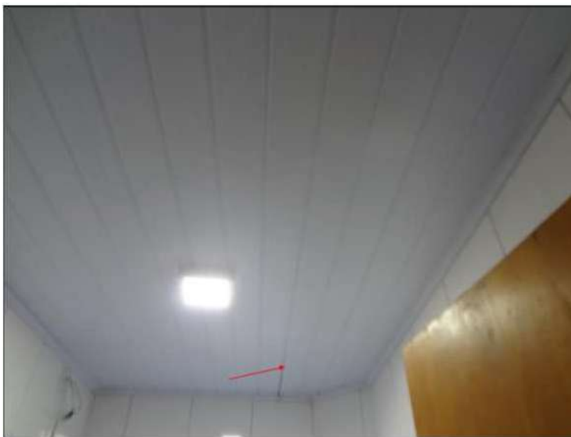
FOTO 50: Forro em pvc com aparente infiltração.
