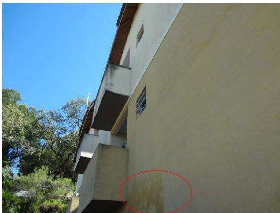
FOTO 42: Infiltração na parede externa.
