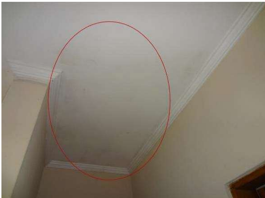
FOTO 62: Presença de infiltração no corredor do imóvel.
