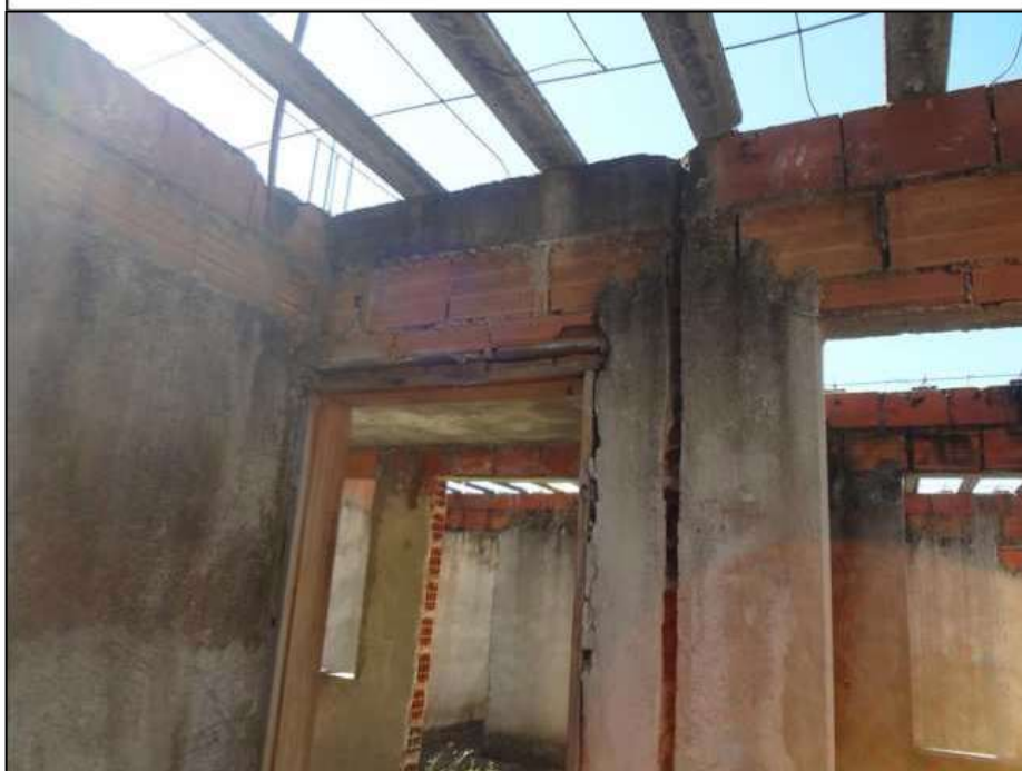
FOTO 21: Caixonetes de portas, em madeira, expostos às intempéries.
