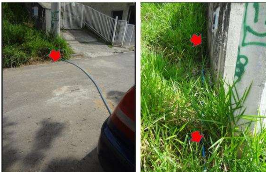
FOTO 38: Observado não haver abastecimento através do SAAE no prédio. A água é conduzida através de uma mangueira que abastece a caixa de água.
