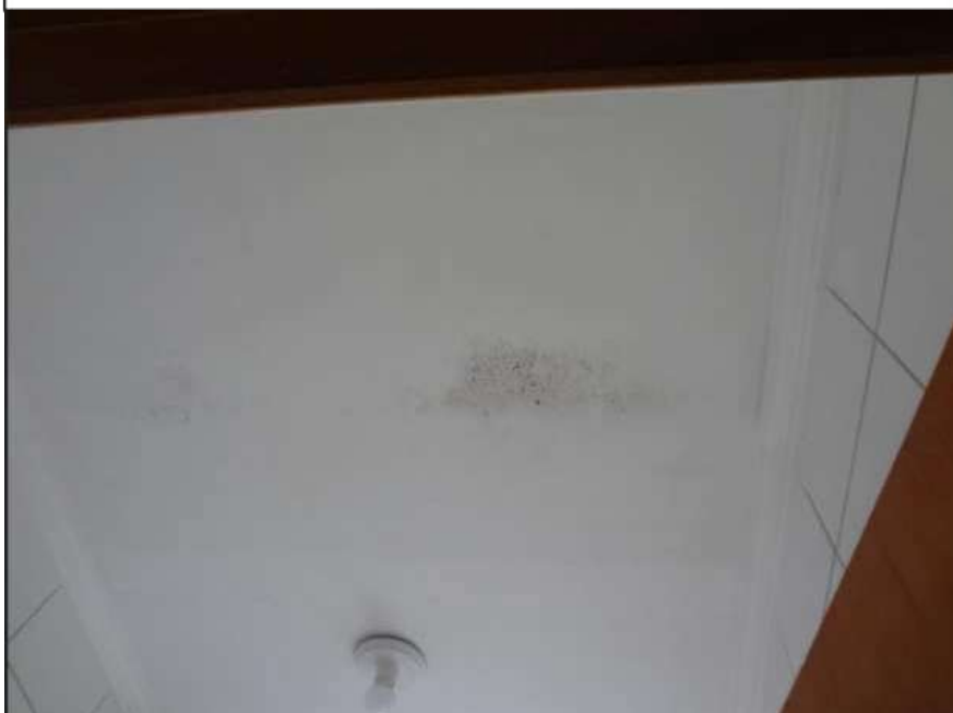
FOTO 63: Presença de infiltração no banheiro.
