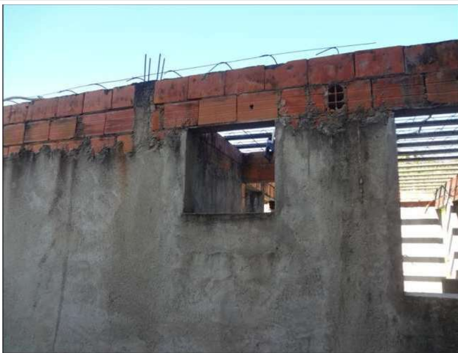
FOTO 18: Ferragens expostas, ausência de esquadrias, tijolos aparentes sem emboço.
