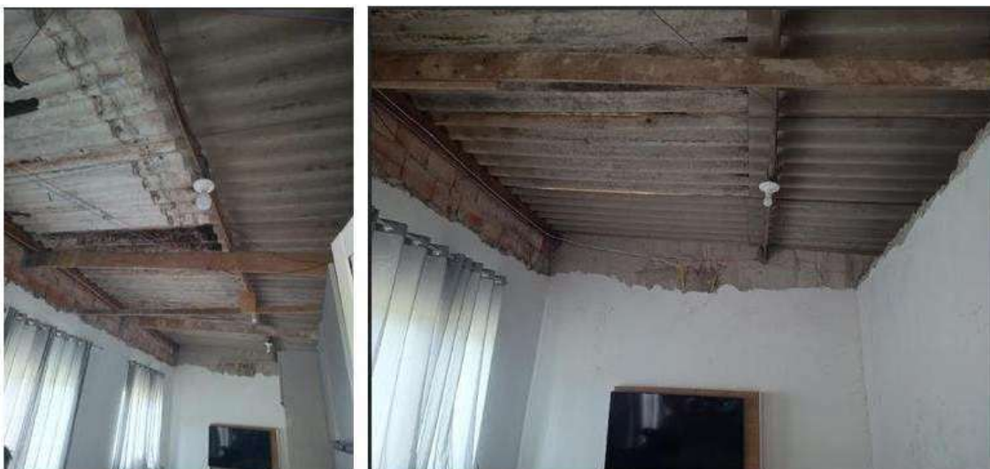
FOTO 80: Telhado da Sala. Telhas de fibrocimento sobre travessas em madeira. Fiação solta.
