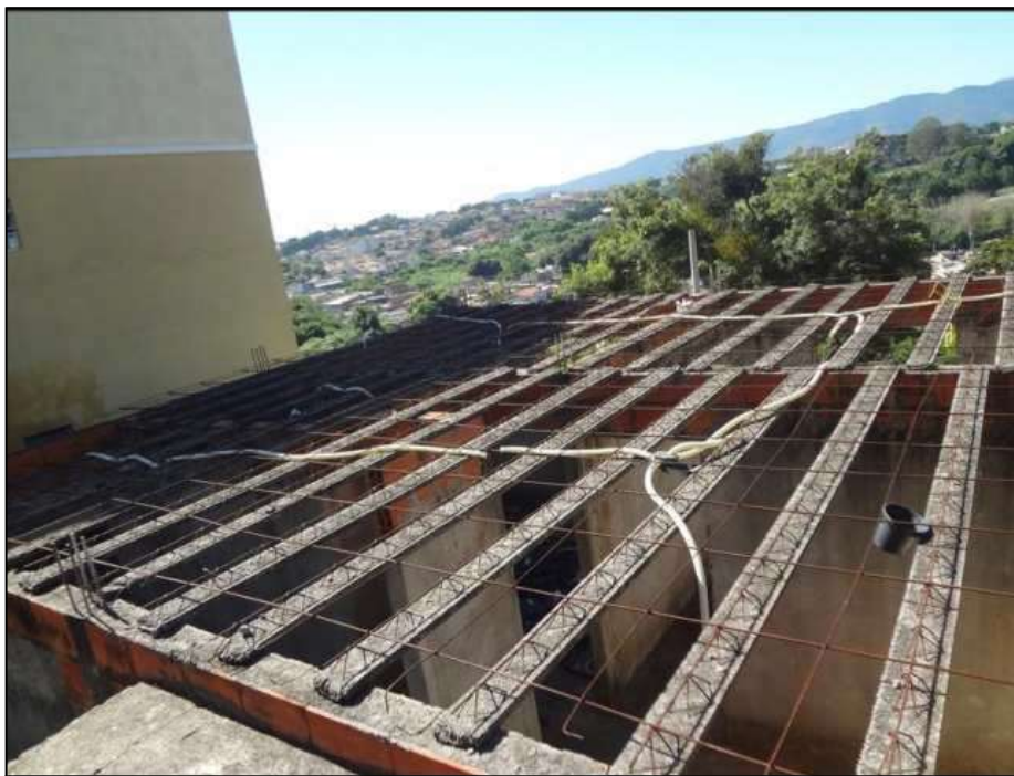
FOTO 16: Treliças de laje existentes por sobre as paredes. Também conduítes expostos. Sem fiação.
