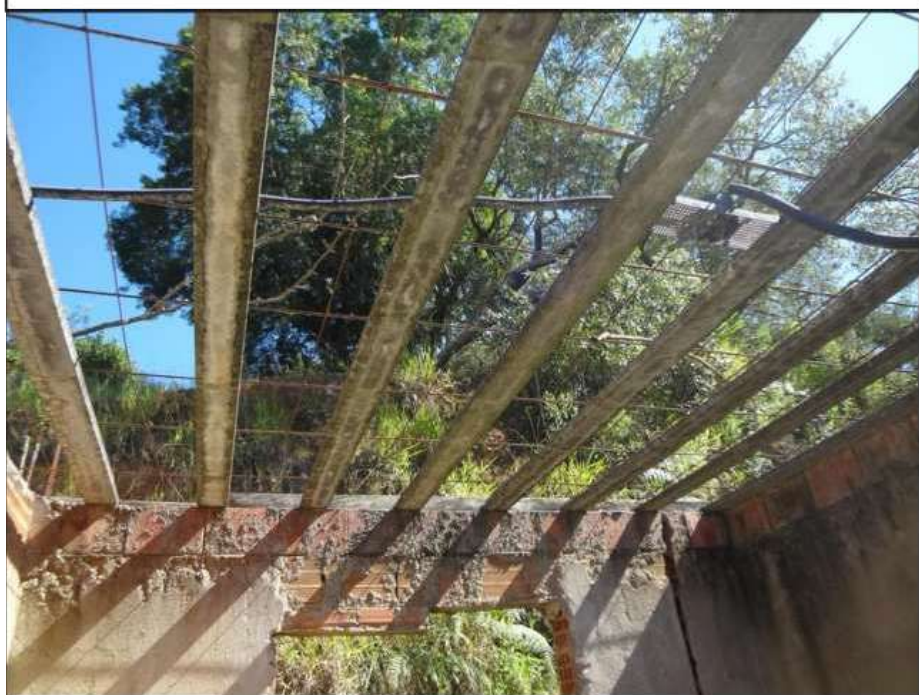
FOTO 23: Vista de quem de dentro da edificação olha para o alto. Ausência de vigas sobre as janelas.
