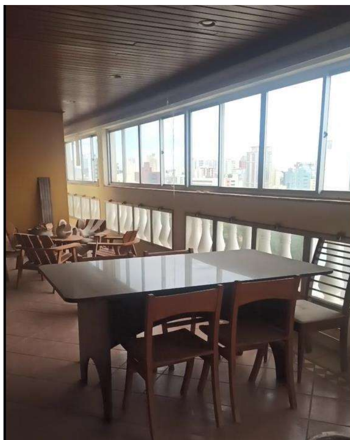
Foto 68 – Forro de madeira no terraço coberto, com sinais de empenamento
