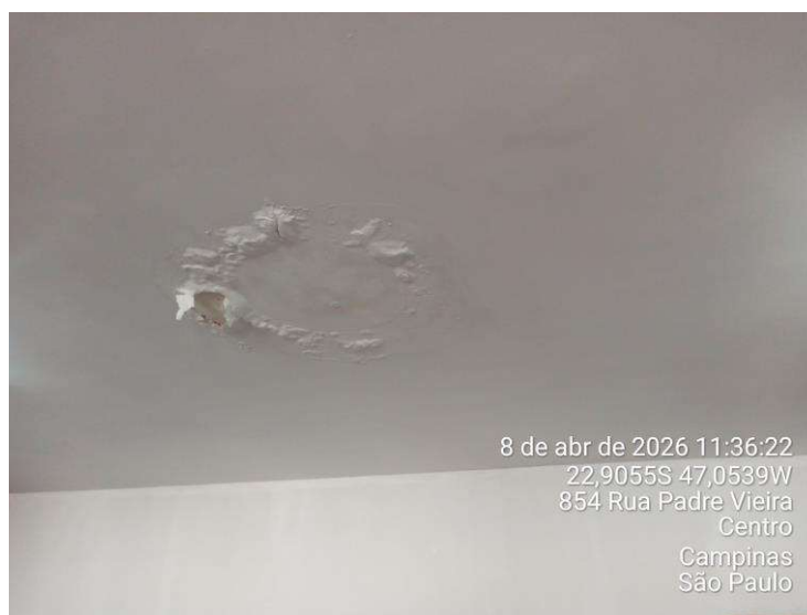
Foto 59 - Presença de sinais de infiltração no teto da sala de estar com bar integrado, com pontos de descascamento e deterioração do revestimento.
