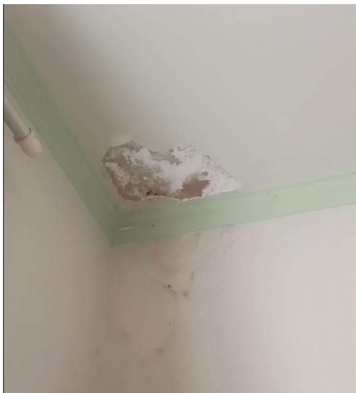
Foto 35 - Evidência de infiltração no teto do dormitório (suíte)
