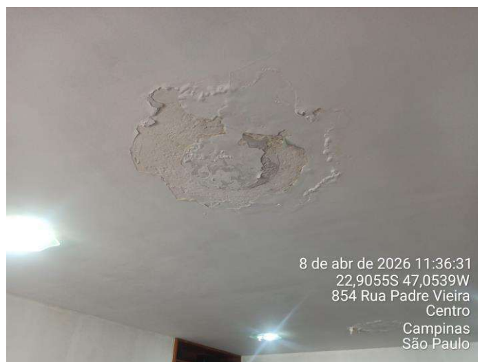
Foto 60 – Outro ponto dentro do mesmo ambiente com sinais de infiltração no teto da sala de estar com bar integrado, com pontos de descascamento e deterioração do revestimento.
