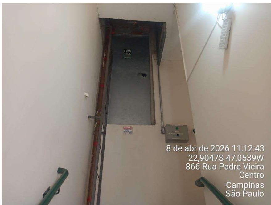
Foto 26 – Casa de máquinas dos elevadores.
