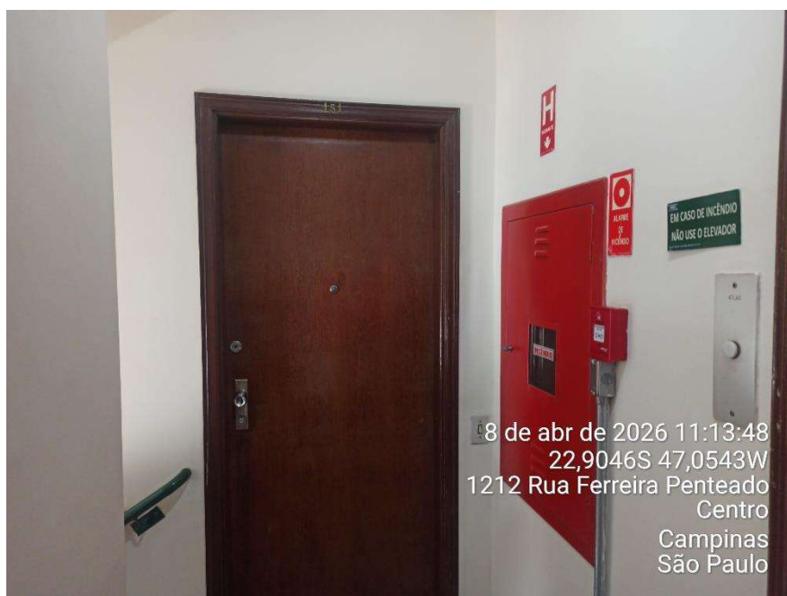
Foto 69 – Porta de Acesso ao IA pelo elevador de Serviço.
