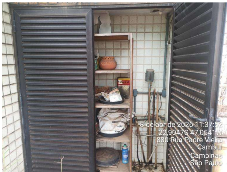
Foto 65 – armário localizado no terraço área descoberta
