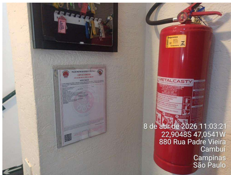
Foto 20 – Térreo com quadro de chaves, CLCB do Bombeiro e extintor.
