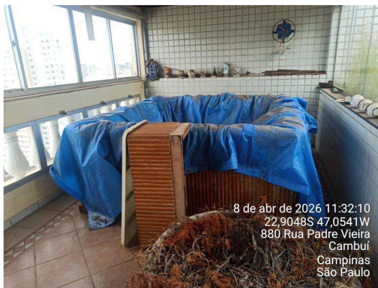
Foto 64 – Hidromassagem no terraço, com indícios de desuso e necessitando de manutenção.
