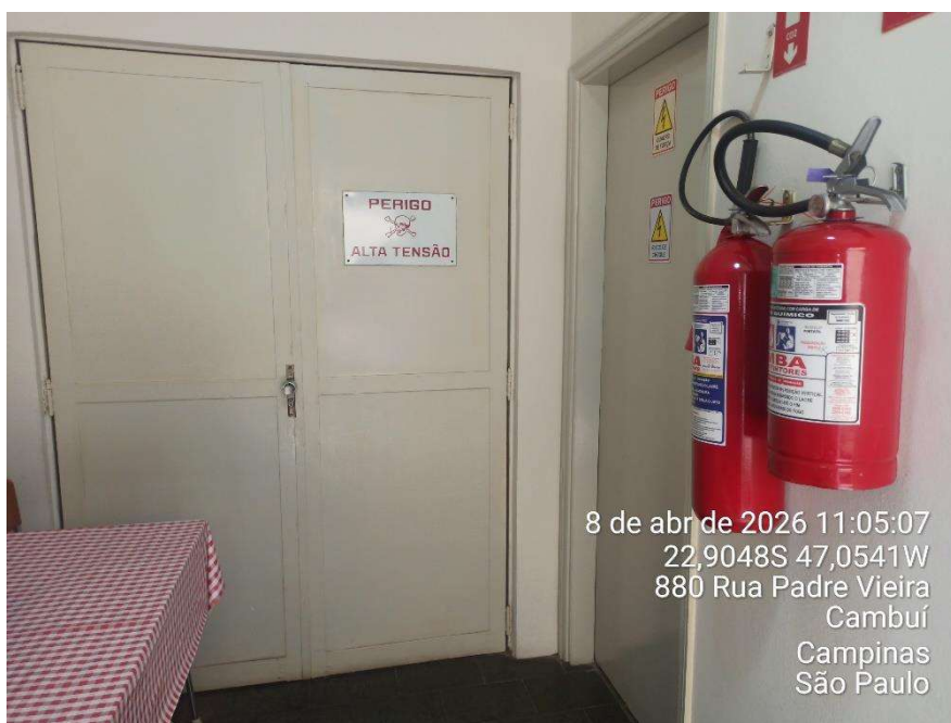
21 – Térreo, Quadro Geral da Energia e Extintores.
