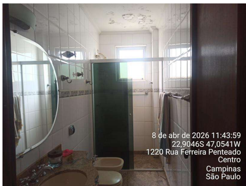
Foto 39 – Banheiro Social (apoio aos dormitórios 1, 2 e 3).
