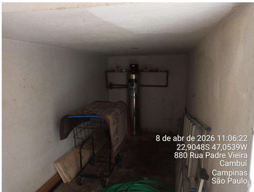
Foto 25 – Sistema de filtragem de água instalado na entrada da rede do imóvel.
