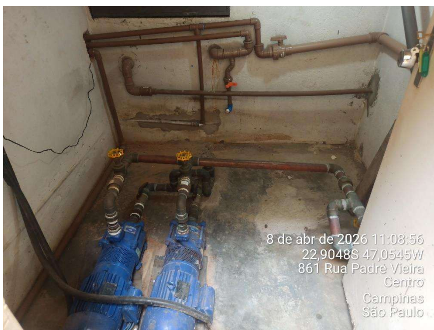
Foto 24 – Térreo, Bombas que enviam águas para as Caixas no topo do prédio.
